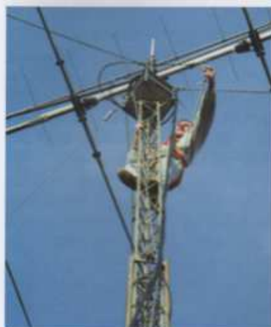
RC11 Antennes : pour la maintenance des antennes en haut du pylône de 15 mètres, il ne faut pas avoir le vertige !
